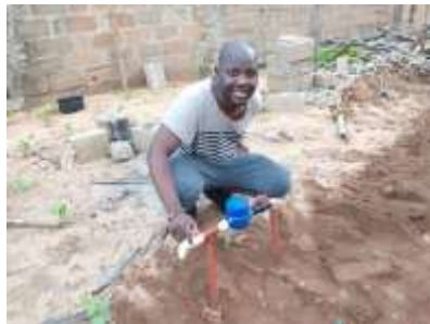
平和の家敷地内にメーター設置。
